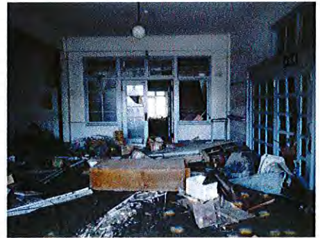
「写真②看護学校内観 1階天井まで浸水」
